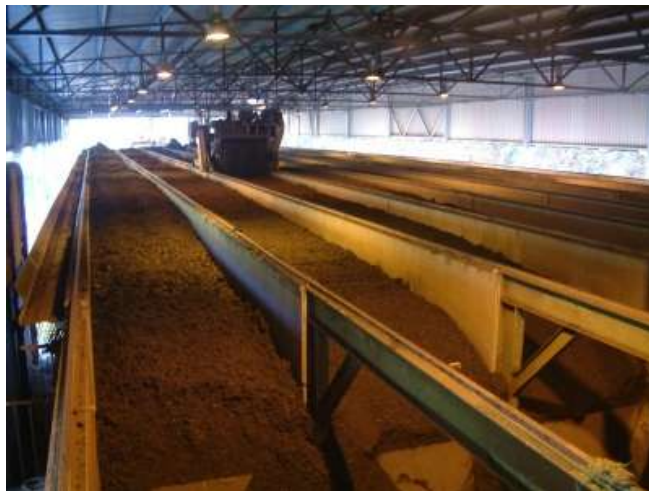
Слика 6.7. Пример постројења за компостирање
